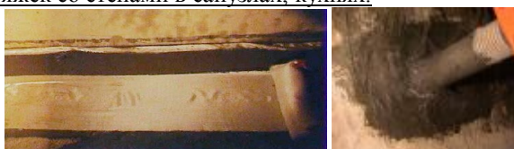
Фото 1 и 2. Гидроизоляция поверхности тонкой не армированной стяжки пожарного резервуара (слева). Гидроизоляция места прохождения трубы, которая проходит через стенку бассейна (справа).
